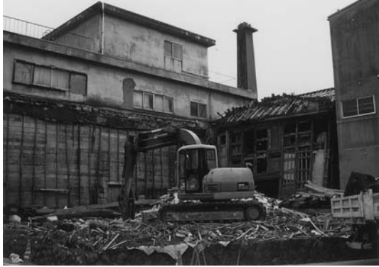
Photo 4 Clearing away the damaged house. 写真 4 損壊家屋の取り除き (2007 年 4 月 23 日)
